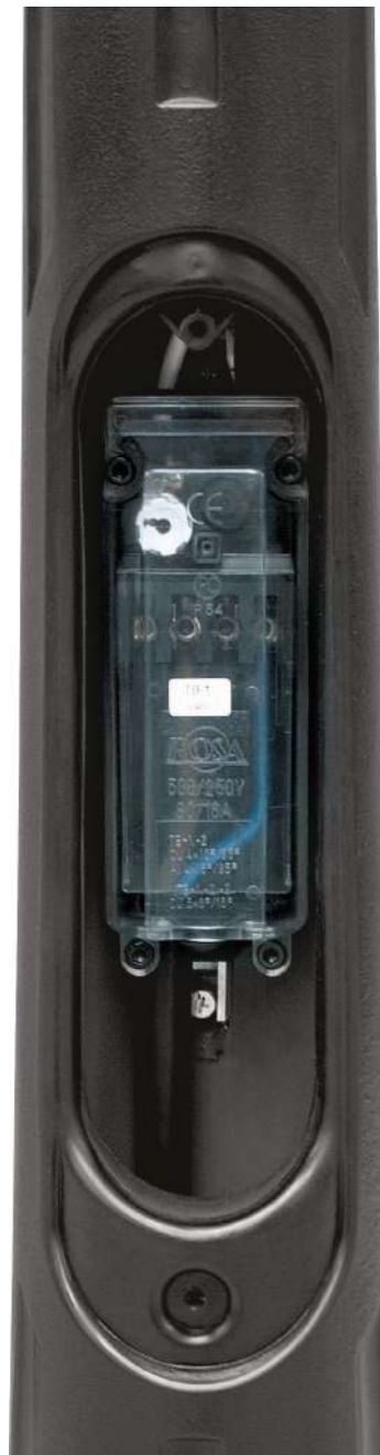
Увідний щиток у ніші сталевій опори з зовнішнім покриттям з синтетичного матеріалу
