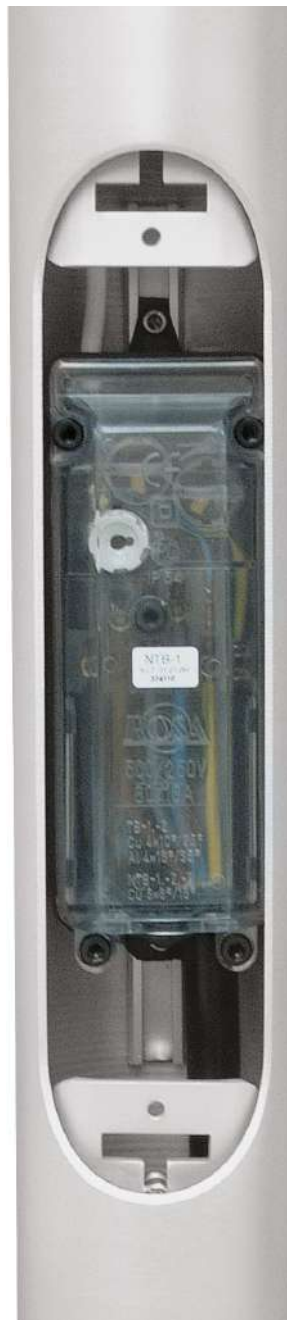
Увідний щиток у ніші алюмінієвої опори
