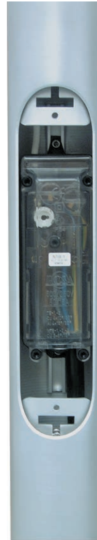
Вводный щиток в нише алюминиевой опоры
