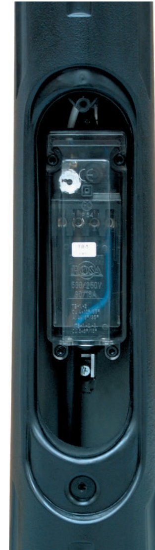
Вводный щиток в нише стальной опоры с внешним покрытием из синтетического материала
